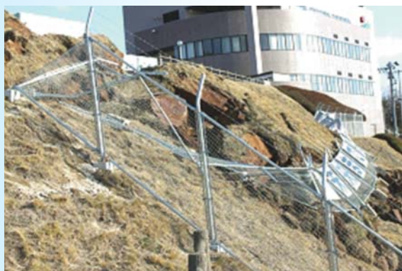
震災直後大野台浄水場
